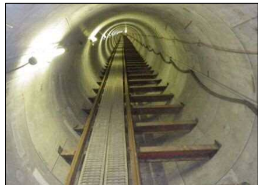
浸水対策 雨水貯留施設 [公園4号幹線]
