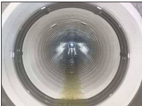
地震対策 管きよ耐震継手 [谷場幹線]
